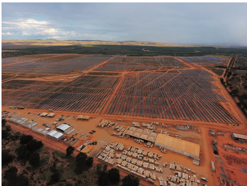
UFV de 185 MWp em Pirapora (MG).
