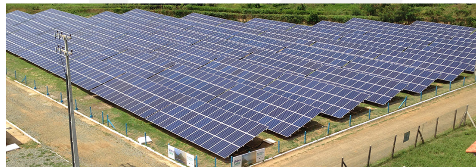
Usina solar fotovoltaica: Fernando de Noronha (PE).
